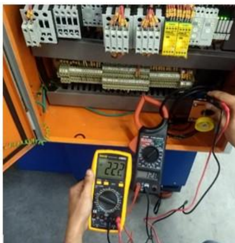
Figura 2 - Medição da corrente e de tensão elétricas.
