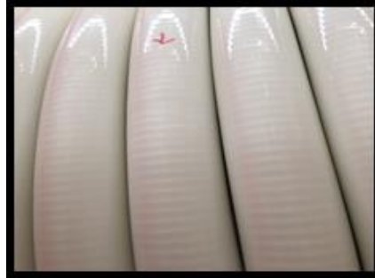
Figura 4 – Branqueamento no duto.
